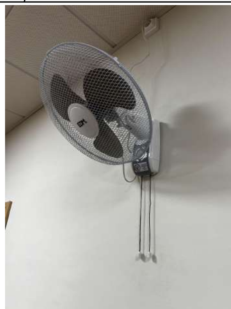
Imagen 16. Ventiladores. IES Los Molinos.
